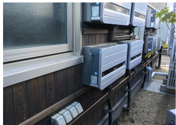
(パワーコンディショナー、非常用コンセント)
